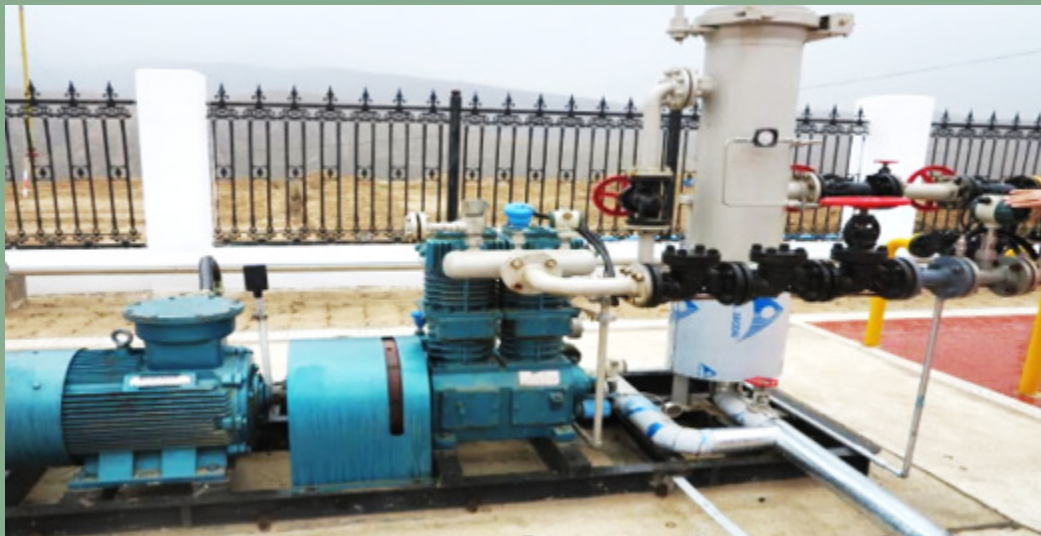
图 4-4 长庆油田伴生气回收利用示范装置
